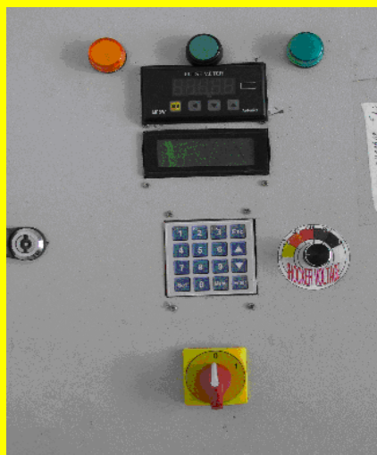
سیستم کنترل قدیم
