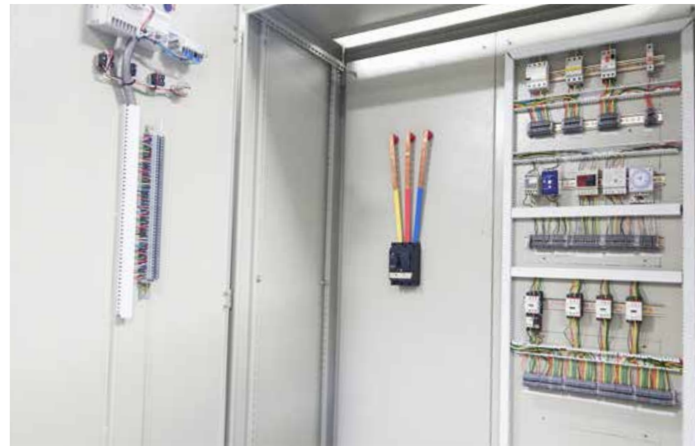
آموزنده کارگاه تاسیسات الکتریکی (WW-102)
