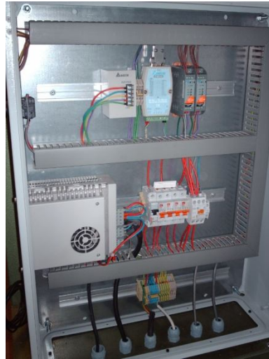
تابلوی کنترل دستگاه
