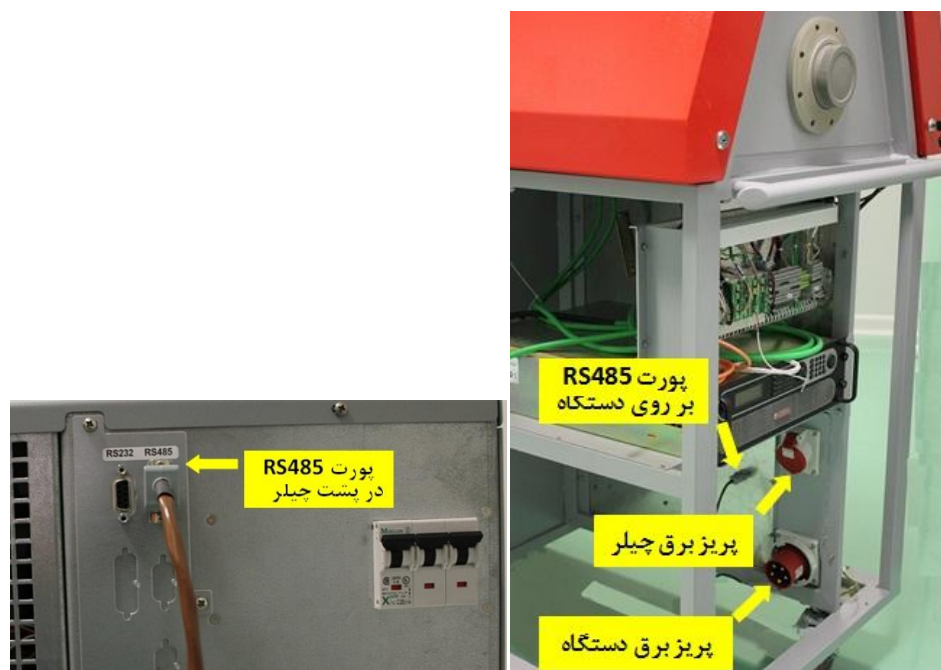
شکل ۳. محل پریز برق دستگاه، پریز برق چیلر و پورت RS485 روی بدنه دستگاه لیزر (راست) و پورت RS485 در پشت چیلر
