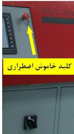
شکل ۱۷. کلید اضطراری خاموش کردن دستگاه لیزر
