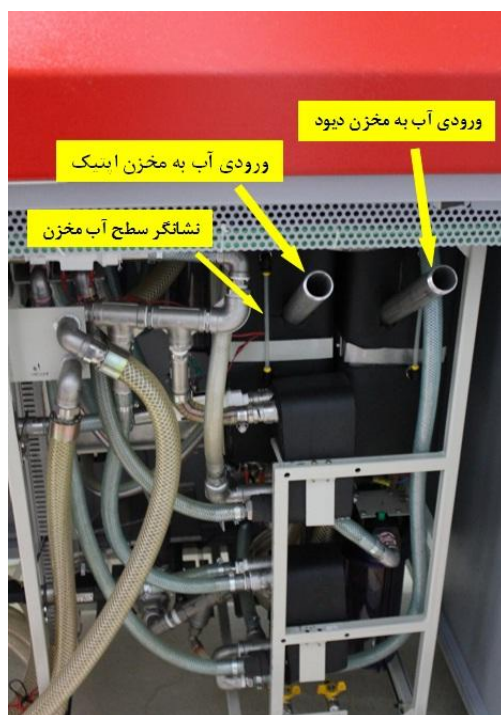
شکل ۸. ورودی آب مخازن سامانه خنک‌ساز داخلی
