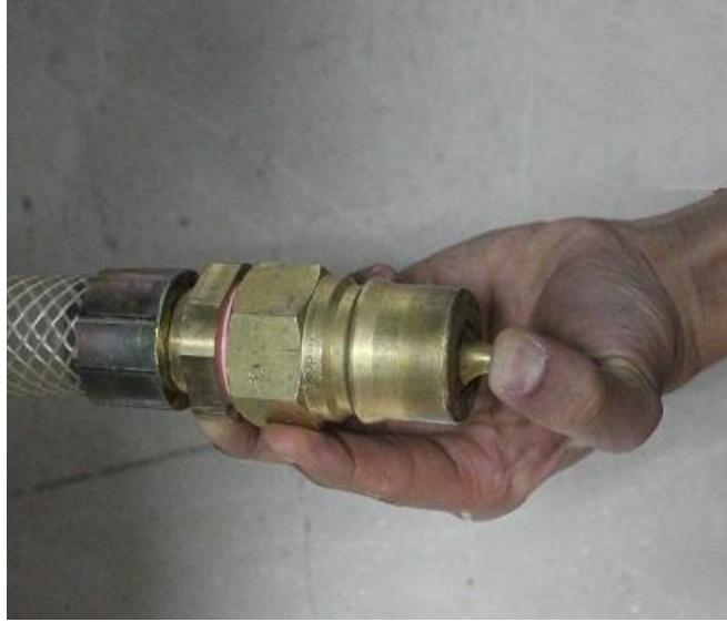
شکل ۱۱. نحوه تخلیه آب شیرهای حامل آب خنک‌ساز چیلر به سامانه داخلی
