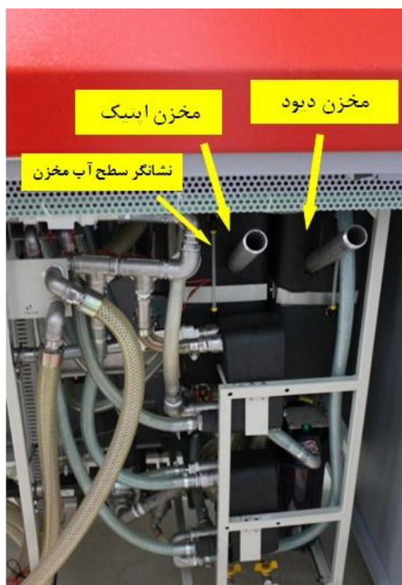
شکل ۲۸. محل مخازن آب دیود و آب اپتیک و نشانگر پر سطح آب مخزن
