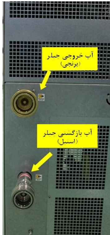
شکل ۴. محل اتصال شلنگ‌های آب خنک‌ساز چیلر
