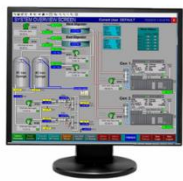
سیستم های مانیتورینگ ایستگاه های گاز
