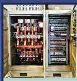
EPC منبع تغذیه DC الکتروکلریناتور در پروژه
